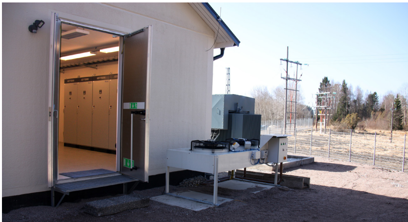
ADF STATCOM-Installation im Fortum Windpark in Kville, Schweden.
