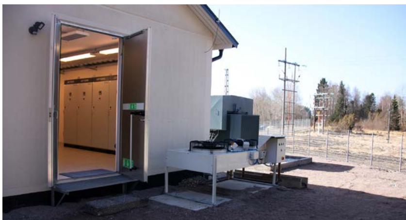
Установка ADF STATCOM на ветроэлектрической станции Fortum в г. Квиле, Швеция.
