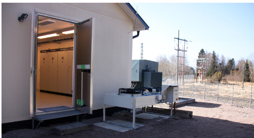
Installazione dello STATCOM ADF presso il parco eolico Fortum a Kville, in Svezia.
